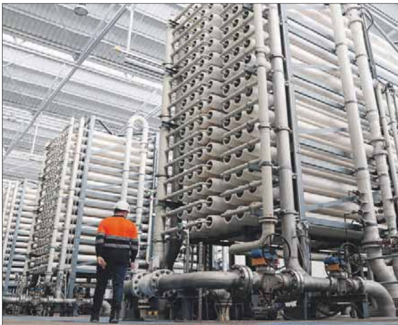
Vista general de la desaladora de Sagunto (Valencia). EFE
