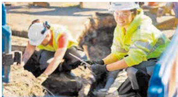
La detección temprana de fugas evita pérdidas innecesarias // ABC
