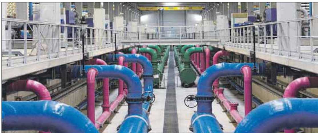
Desaladora de Águilas (Murcia). EE
